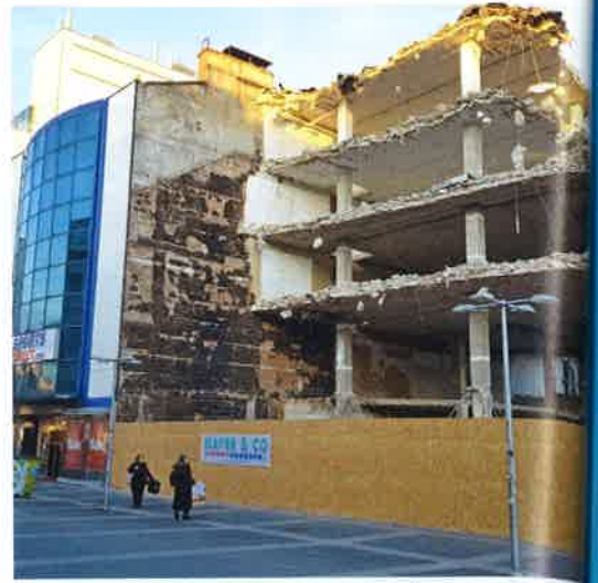
Strukturwandel Beispiel 2: Im Jänner 2020 wurden die letzten Reste des ehemaligen Modehauses Tlapa abgerissen. Nun entsteht hier ein multifunktionales Gebäude, bestehend aus Retail-, Gastrofläche, Hotel und Mikroapartments.
